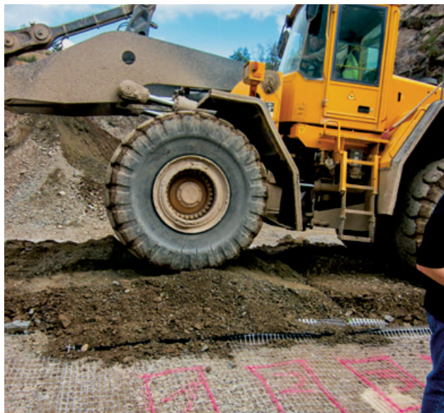
Figura 15 Factor de daño de instalación ("RF10/A2") determinado por una prueba de campo en una cantera.
