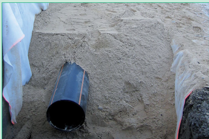
Figura 1: Secutex® utilizado como geotextil de separación entre el lecho de arena entre la tubería y el subsuelo limoso.
