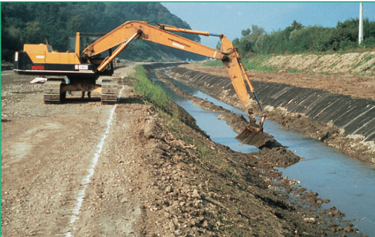
Figura 50 Cobertura de suelo de Secumat® para el control de la erosión en un colector de agua de lluvia (Albertville, Francia).
