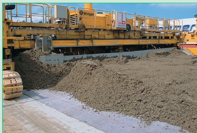
Figura 4: Colocación de concreto sobre Secutex®, que actúa como un separador, filtro y capa de drenaje entre el subsuelo y el camino.
