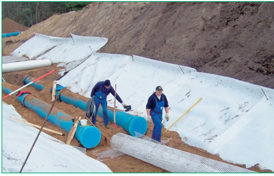
Figure 86 Instalación de Combigrid® para aumentar la base de la tubería (Wismar, Alemania).
