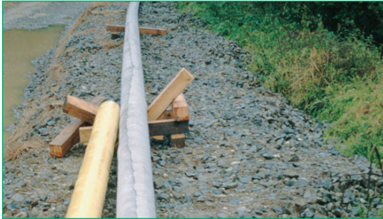
Figura 82 Envoltura de protección de una tubería de Secutex® (Arnstorf, Alemania).
