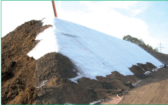
Figura 44 Secugrid® garantiza la estabilidad del talud en una barrera contra ruido (A33 Bielefeld, Alemania).
