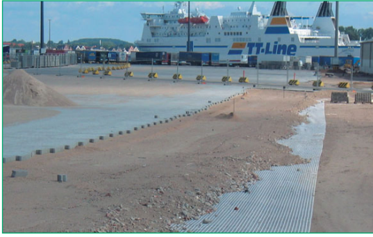
Figura 29 Secugrid® pretensado Secugrid® instalado bajo una capa de base para tráfico pesado (Lübeck, Alemania).
