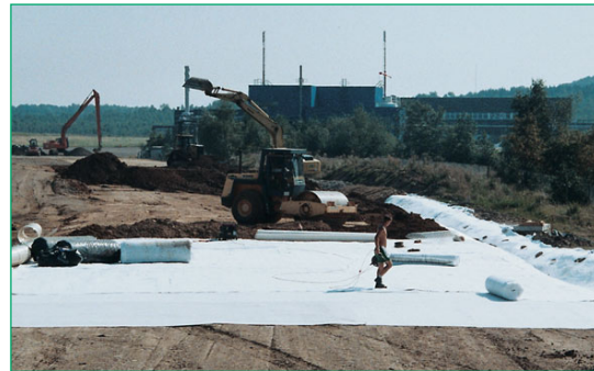
Figura 34 Instalación de Bentofix® GCL como protección para aguas subterráneas debajo de la autopista B 82n (Langelsheim, Alemania).
