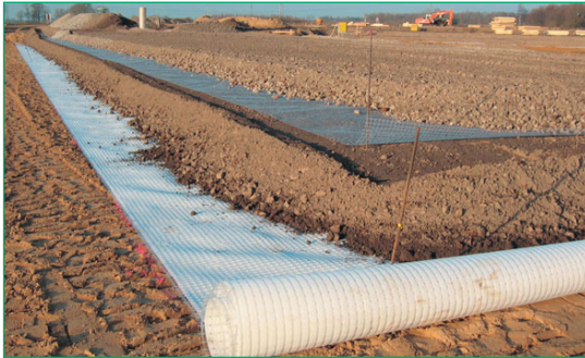
Figura 73 Colocación de cubierta de suelo sobre la estructura reforzada con Combigrid® y Secugrid® (Nordenham, Alemania).
