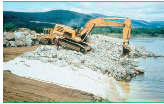
Figura 12 Cobertura del pedraplén sobre filtros de geotextiles Terrafix® no tejidos (Fort William, Escocia).
