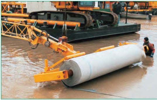
Figura 26 Instalación submarina del revestimiento de arcilla geosintética Bentofix® BZ 13-B, manufacturado de fábrica con material de lastre (DEK, Greven, Alemania).
