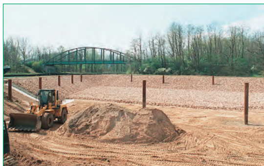
Figura 29 Sellado del puerto para yates con revestimiento de arcilla geosintético Bentofix® (MLK, Minden, Alemania).
