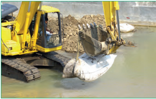
Figura 17 Instalación de contenedores de arena de Roca Suave en el Río Cibadak (Bogor, Indonesia).
