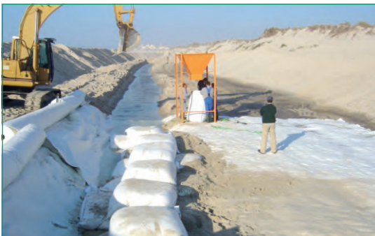
Figura 10 Relleno de arena de Roca Suave para la protección de la costa (Figueira da Foz, Portugal).
