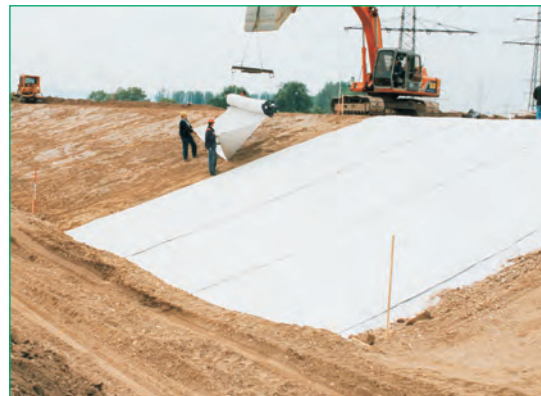
Figura 37. Instalación de un revestimiento de arcilla geosintética Bentofix® en un dique con una sola barra esparcidora de instalación (Offenburg, Alemania).
