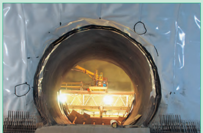
Fig. 21: Sellado "360°" en un tubo de conexión.
