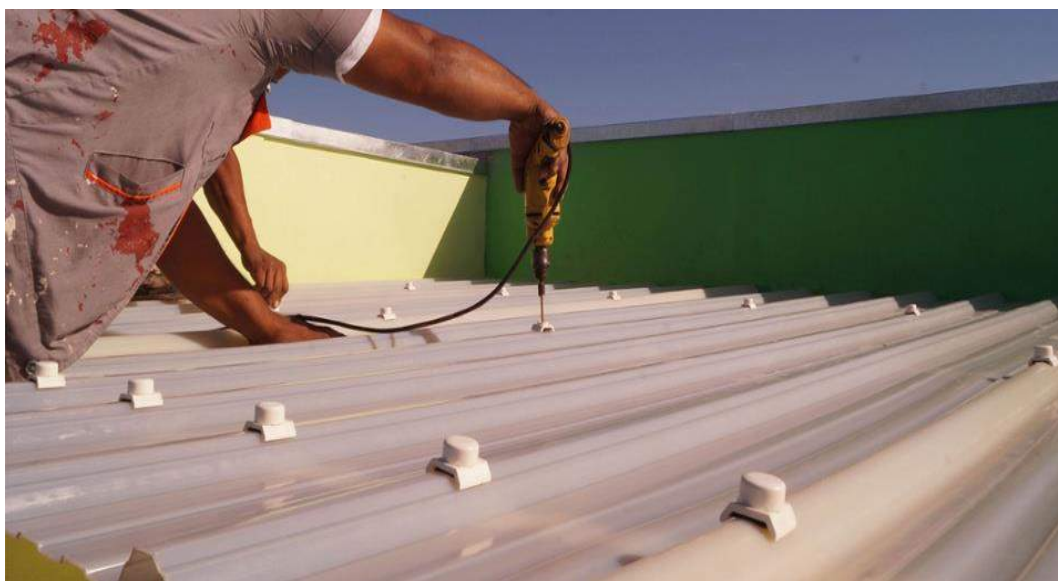
Figura 5. Instalación de lámina tricapa. Se aprecia el momento de la instalación de la lámina de PVC tricapa.
