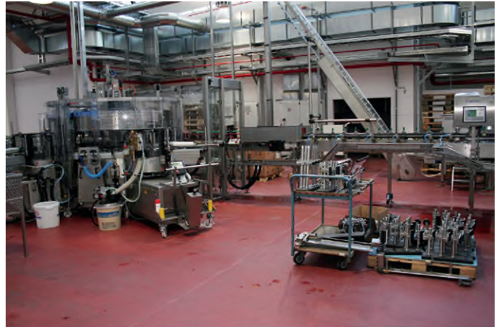
Unsere Referenz in Kitzingen (Deutschland): Abfüllanlage der Winzergemeinschaft Franken eG
